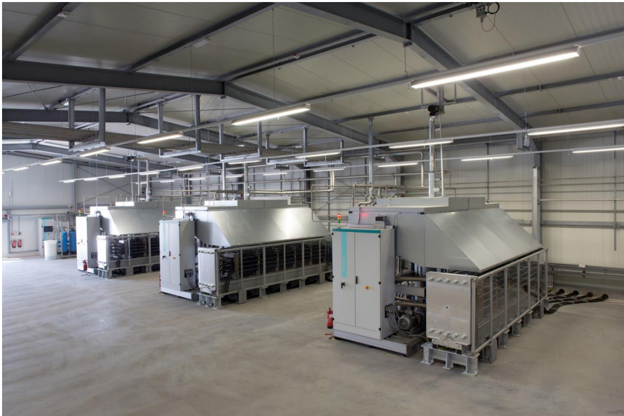
Abbildung 3-5: Elektrolyseure im Energiepark Mainz (Quelle: https://www.energiepark-mainz.de/projekt/bilder/ )
